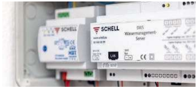
Digitales Wassermanagement: Via SWS-Server können u.a. Stagnationsspülungen und Armaturen-Parameter zentral und flexibel programmiert werden.
