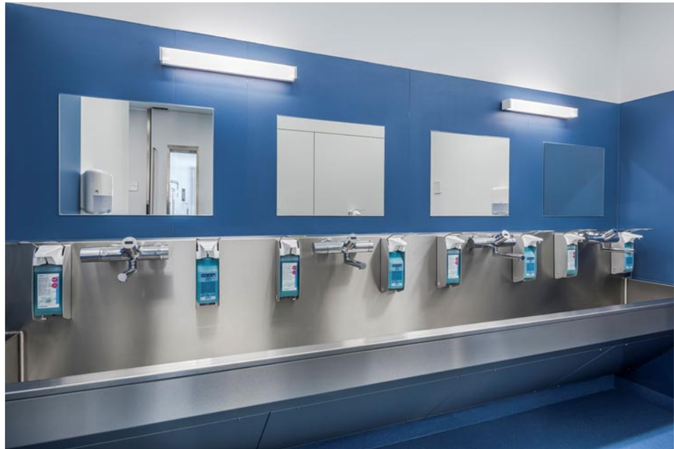
Um der Trinkwasserhygiene gerecht zu werden, hat die Charité in OP-Bereichen elektronische Armaturen in Kombination mit einem Wassermanagement-System eingesetzt.
